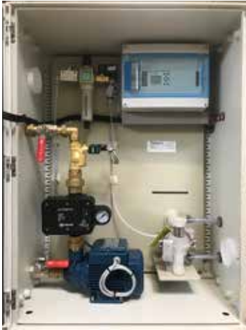
Armoire DPVR1 (1 stalle)
