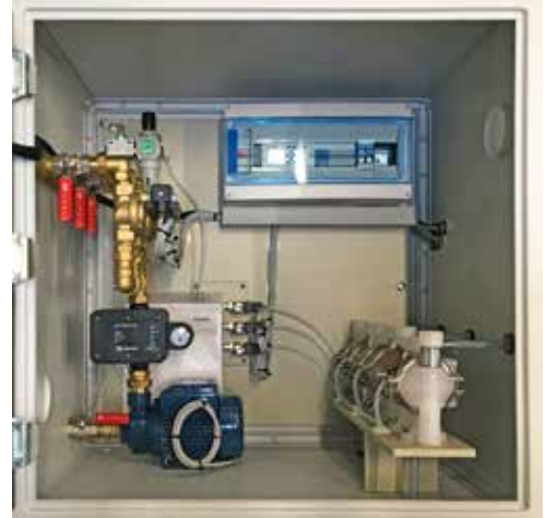
Armoire DPVR3 (3 stalles)
